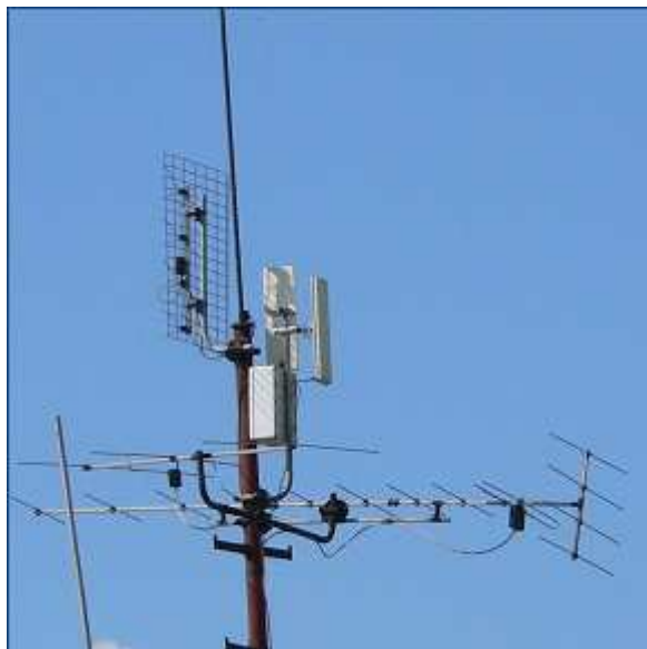
Různé antény na střeše panelového domu
