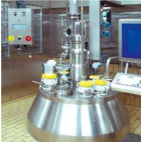
Místnost reaktorů s pohledem na hlavu reaktoru a na nevýbušné vybavení
