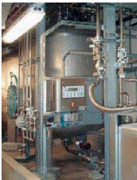
Technologická čistička vody s lokálním nevybušným řídicím panelem Exicom vestavěným do nerezové skříně 8125
