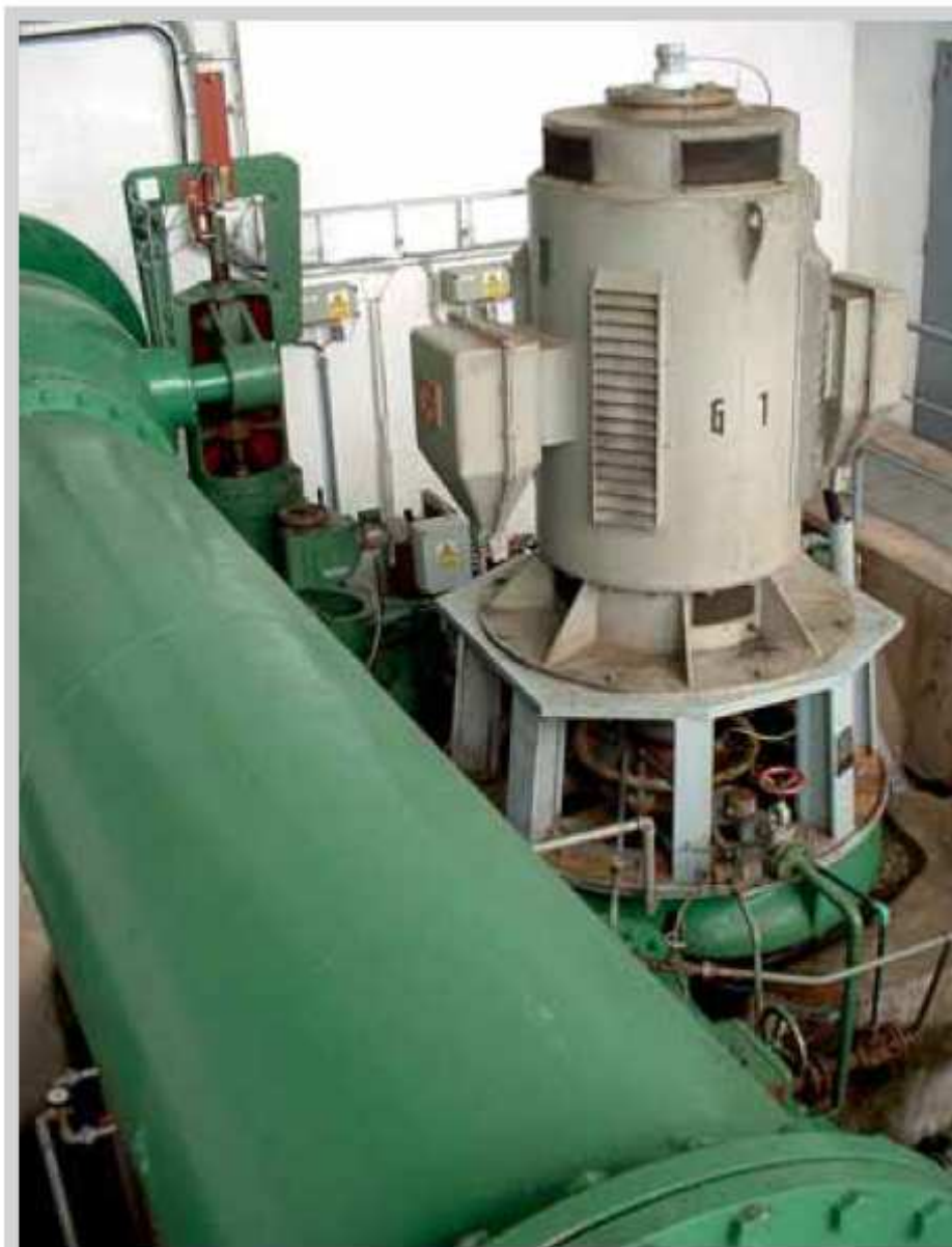
Turbína s generátorem na přivaděči v úpravně pitné vody nahradí škrťací armatury. Foto: Karel Srdečný, EkoWATT
