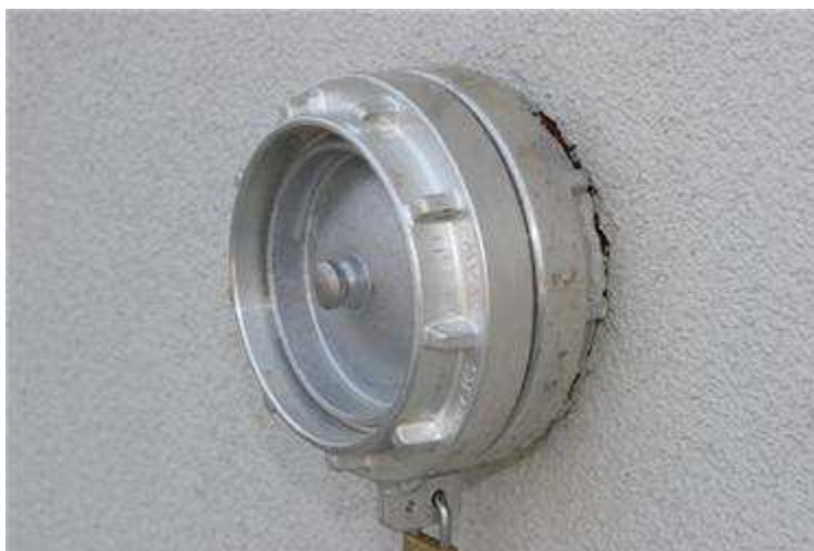
Plnicí otvor zásobníku na pelety na stěně domu
