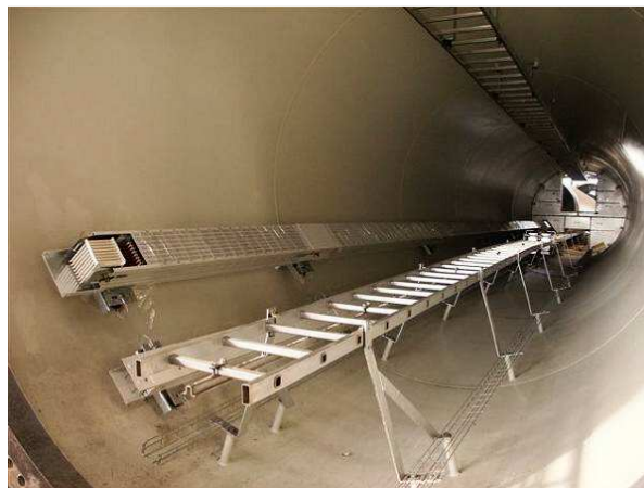
Vybavení segmentu stožáru žebříkem, kabelovými lávkami, někdy i výkonovými kabely
