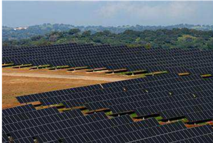
Fotovoltaická elektrárna Serpa (Portugalsko) o výkonu 11 MWe Zdroj: SunPower Corporation
