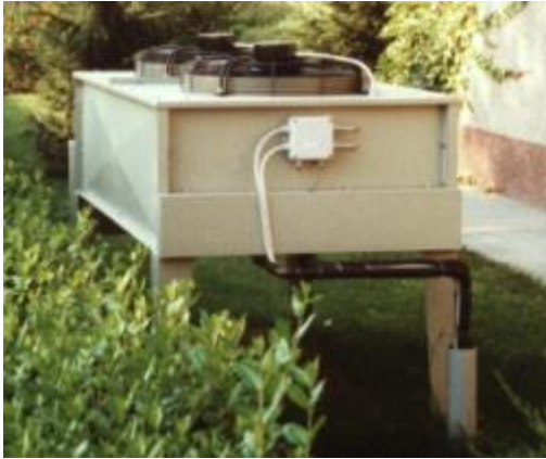
Venkovní jednotka tepelného čerpadla vzduch/voda
