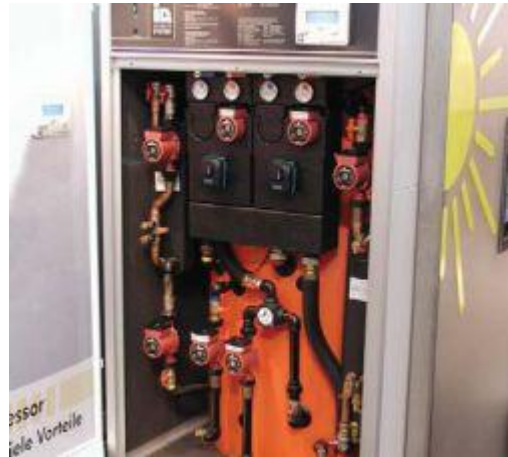
Spotřeba oběhových čerpadel v TČ někdy není zanedbatelná
