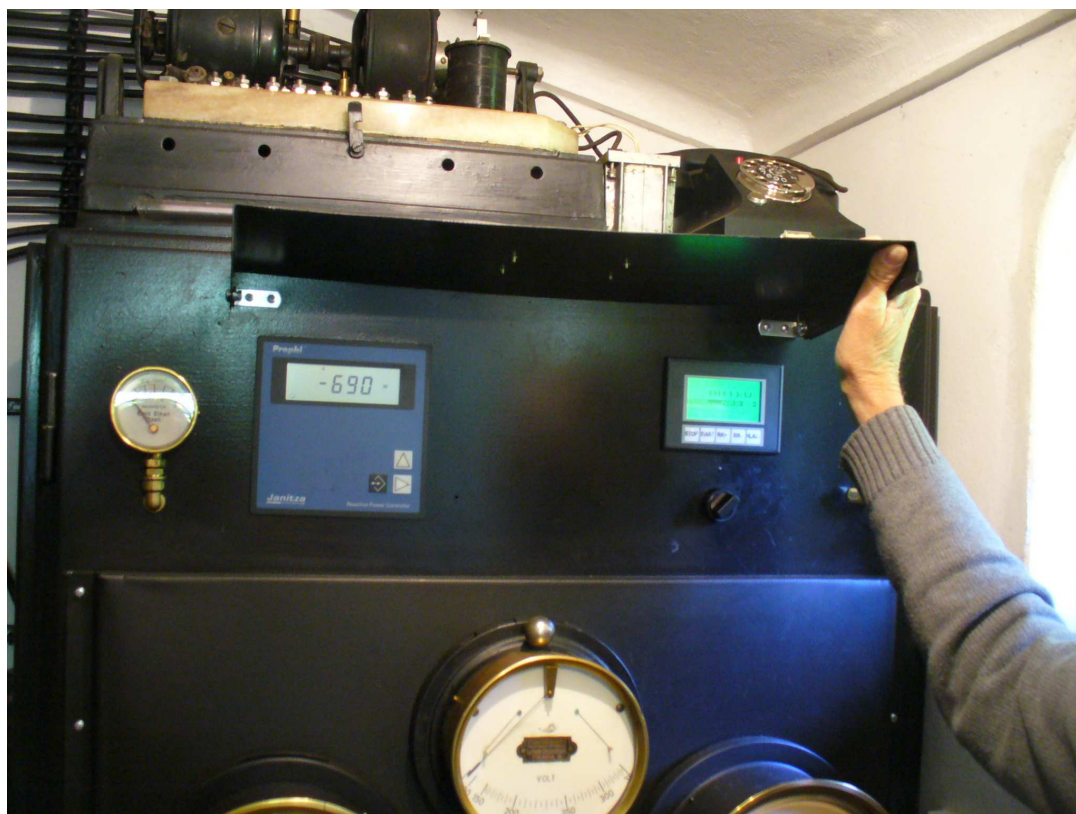
Obr. 3 Strojovna a potřebné měřicí přístroje ke sledování funkce elektrárny
