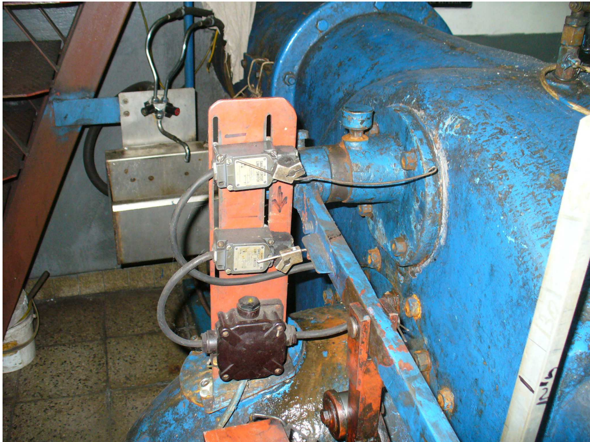
Obr. 13 Dálkově řízené elektrické spínače pro ovládání Francisovy turbíny
