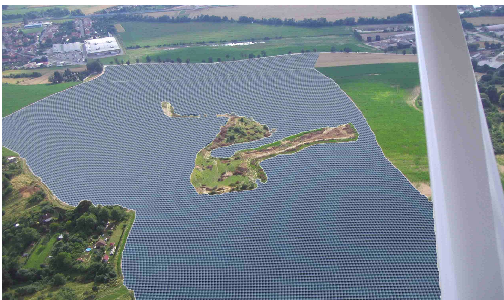
obr.: PV elektrárna u Brna
