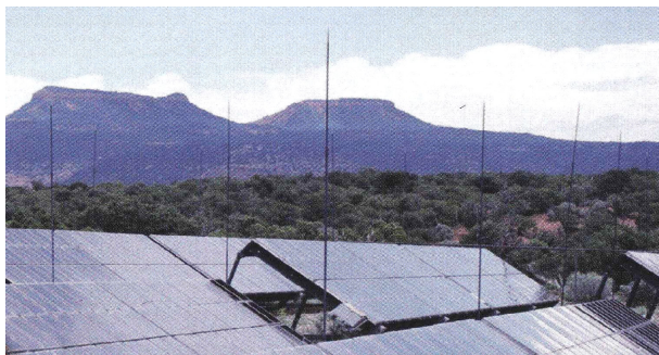
obr.: Skutečné provedení oddáleného hromosvodu
