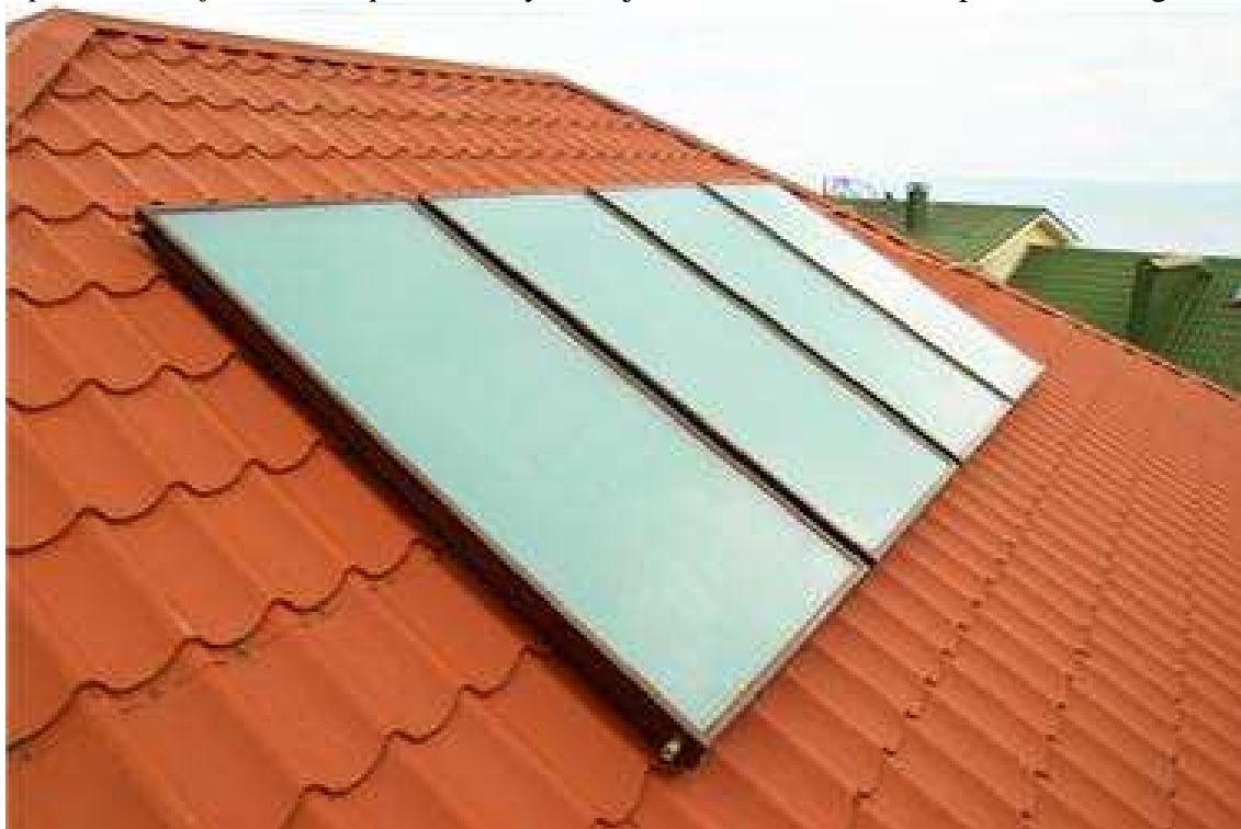
Solární kolektory slouží pro ohřev vody nebo přitápění. Zdroj: Istockphoto.com
