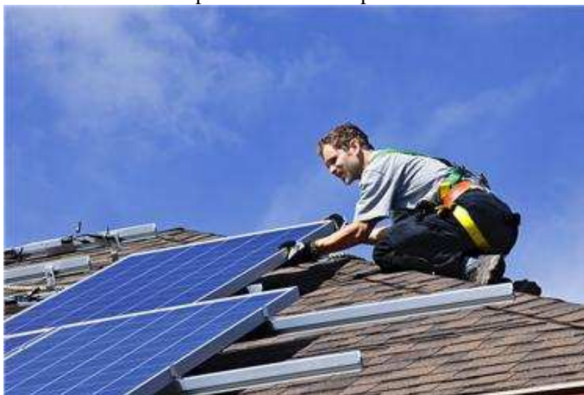
Malé solární instalace mají stále stopku
