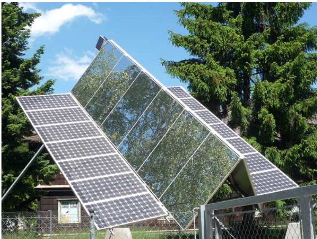
Sluneční park ve Strašicích u Rokycan. Vědecko-technický park areál můžete i navštívit.
