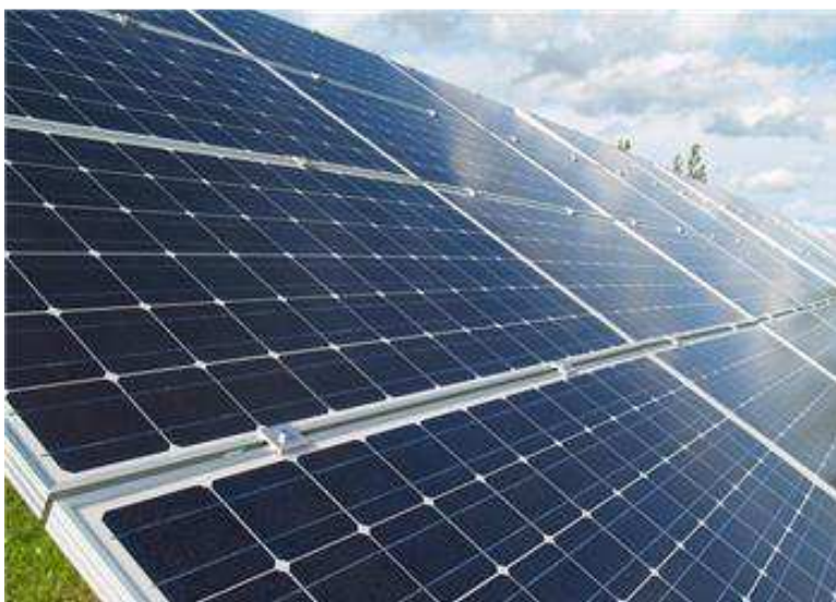
Elektrárna v Kobylicích má 1 300 panelů, každý s výkonem 175 Wp. Foto: autor
