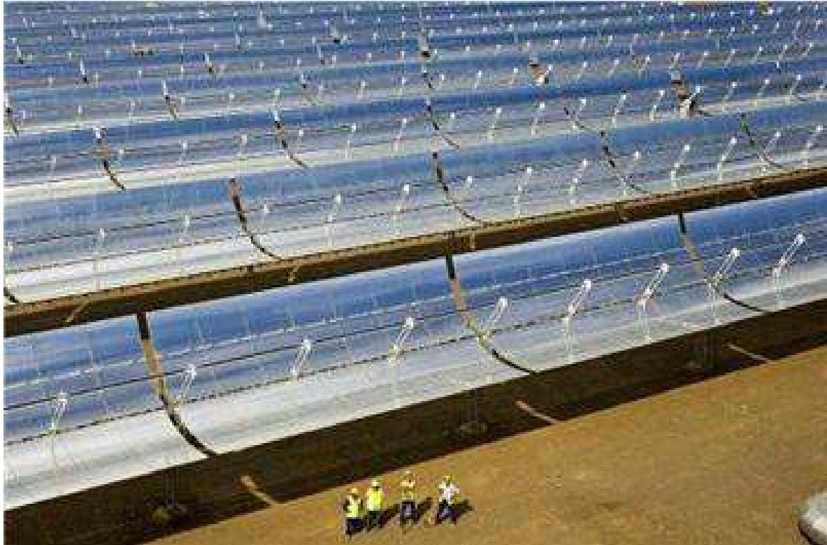
Solární jednotky Andasol 1 (7 488 kolektorů, 209 664 parabolických zrcadel). Zdroj: Solar Millennium AG
