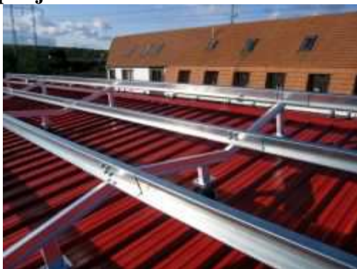
Brno konstrukce na fotovoltaiky
