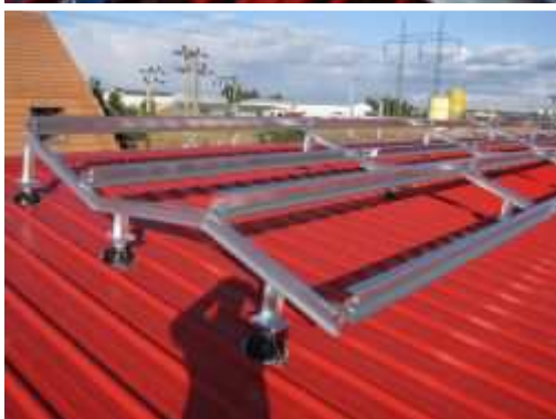
Ocelová konstrukce fotovoltaiky
